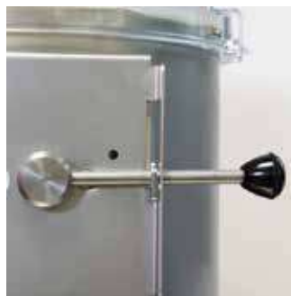
Sistema anti-retorno en la entrada de agua.
